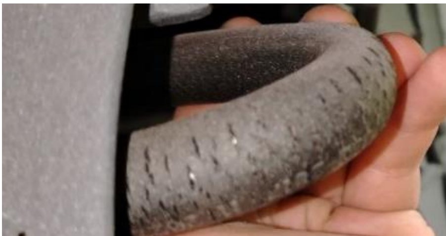
Рисунок Е.1 Пример поверхностных трещин
